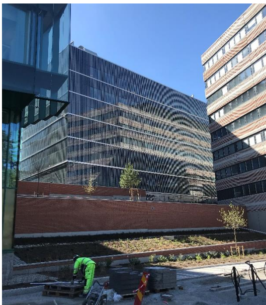
KM-B från Solnavägen, synligt mellan Biomedicum och Widerströmska huset. I förgrunden arbete med gång- och cykelbana.
